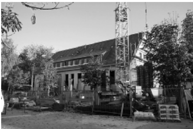
Beim Umbau und der Sanierung des Gemeindehauses, dem größten Hochbauprojekt der Gemeinde in diesem Jahr, gibt es unerwartete Statikprobleme und deshalb Mehrkosten von 109.000 Euro.
