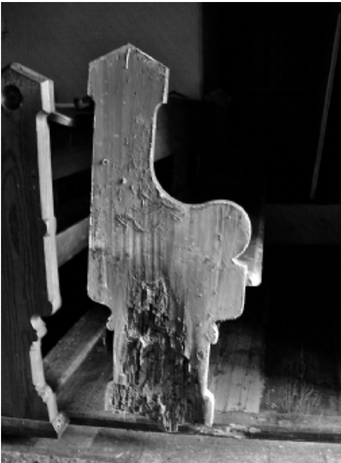
Kirchenrenovierung: Die ehrwürdigen Sitzbänke sind seitlich vermodert, wo sie an der Innenwand des Turmes montiert waren, denn diese Wand ist feucht.
