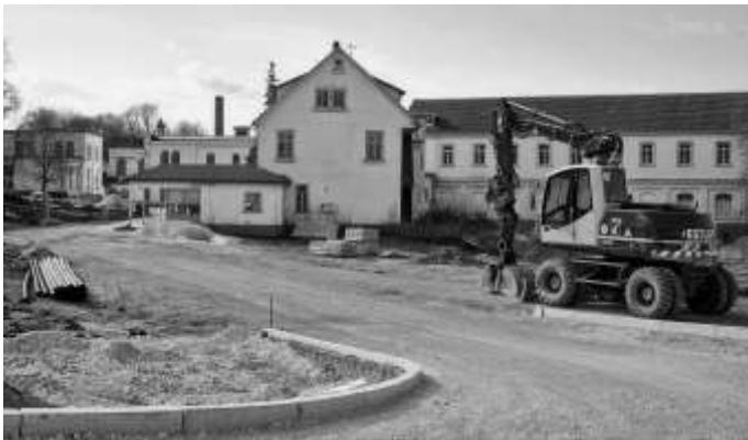
Gebäude an der früheren Spinnerei-Pforte (Vordergrund) und ehemaliges Verwaltungsgebäude (rechts) - hier haben die Künstlerinnen ihre Ateliers
